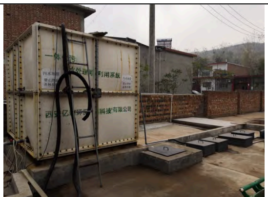
一体化污水处理设施
