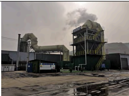
脱硫塔、湿电除尘器
