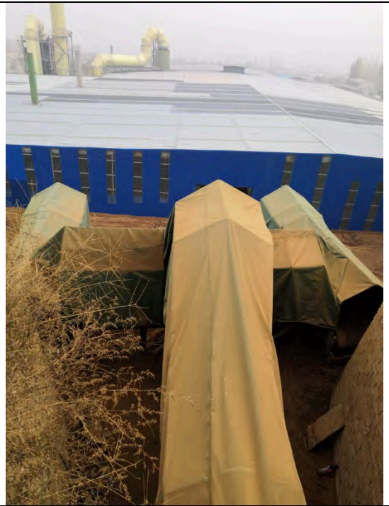
封闭厂房、车间外封闭输送
