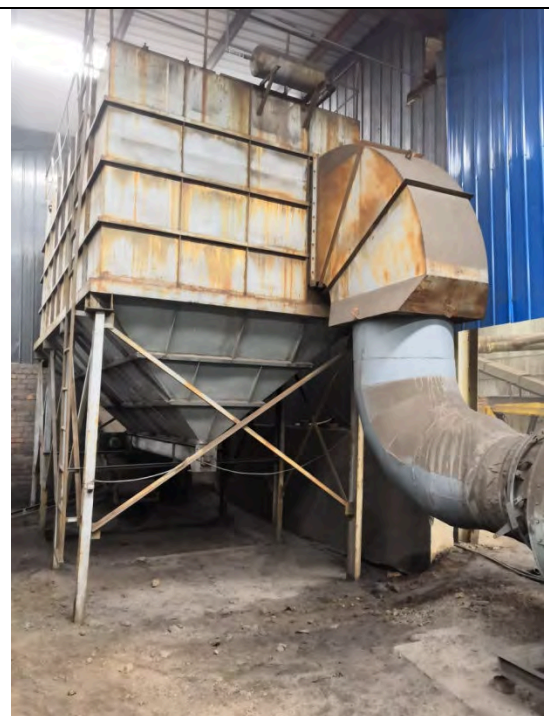
破碎工序布袋除尘器
