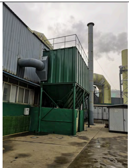
送料工序布袋除尘器
