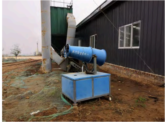
粘土开采区环保除尘雾炮机
