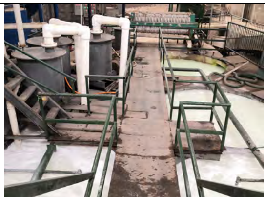
脱硫碱液循环池
